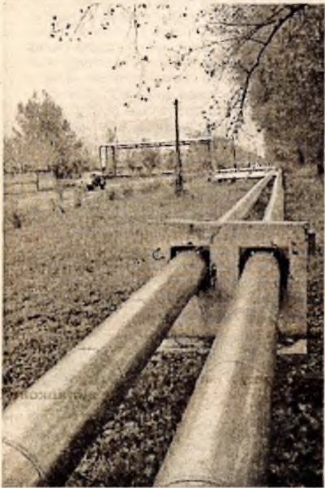
Зовнішня тепломережа м.Чорнобиля загальною довжиною близько 100 км надає «атомній столиці» вигляд гігантського космічного об'єкта.
