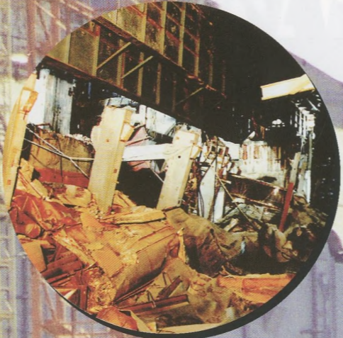
Відхилення колон по ряду В на деаераторній етажерці
