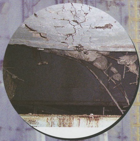
Деформація бетонних плит на деаераторній етажерці
