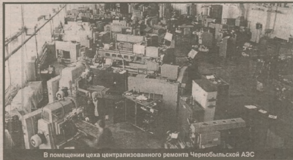
В помещении цеха централизованного ремонта Чернобыльской АЭС
