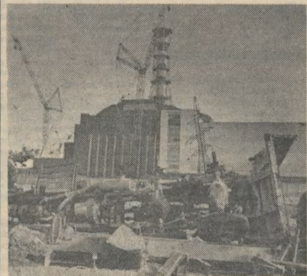
ИЗ ФОТОАРХИВА «ТРУДОВОЙ ВАХТЫ». Лето 1986 года. Идет возведение объекта «Укрытие». Фото Ивана ЛЫСЕНКО.
