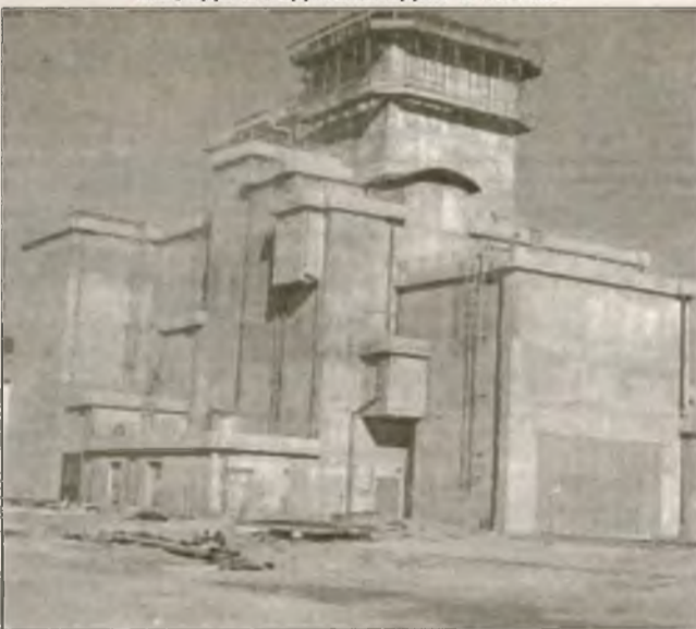
На стройплощадке "ХОЯТ-2" сейчас тихо и спокойно. В период строительных работ пыль здесь стояла столбом
