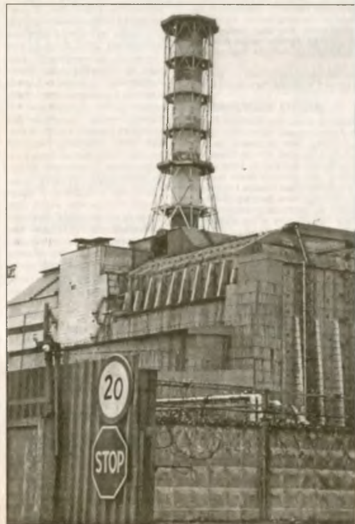
● Об'єкт «Укриття» зблизька. Всі конструкції, в які «одягнутий» колишній четвертий блок, потребують ремонту.
